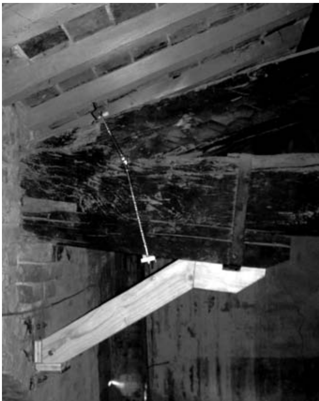
Figura 13. Sostegno di nodo di capriata, la cui catena è gravemente danneggiata e deformata, con contraffisso ligneo (Tampone con la collaborazione di P. Derinaldis, Certaldo, 2009).
