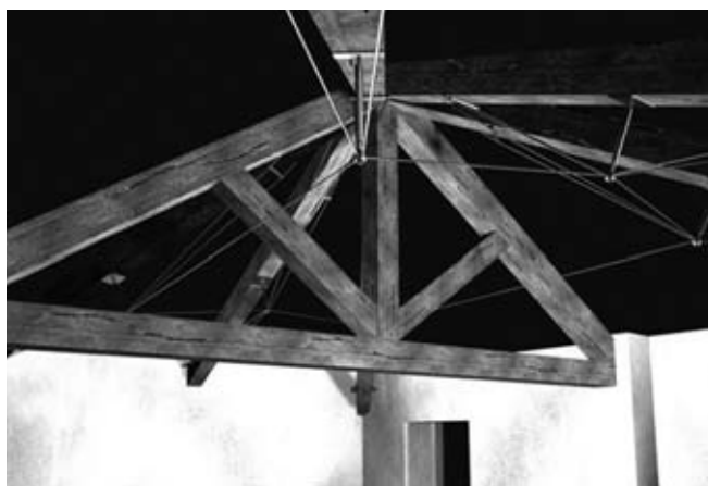
Figura 3. Villa Della Porta Bozzolo, Casalzuigno, Varese: consolidamento della capriata mediante realizzazione di struttura reticolare mista.
