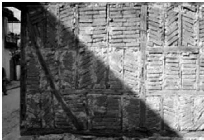
Figura 3. A sinistra: esterno di una parete di una casa Himiş nella zona colpita dal terremoto del 1999, a Izmit, Turchia. A destra: la stessa parete visibile dall'interno dove si notano le fessurazioni nell'intonaco causate dal terremoto.
