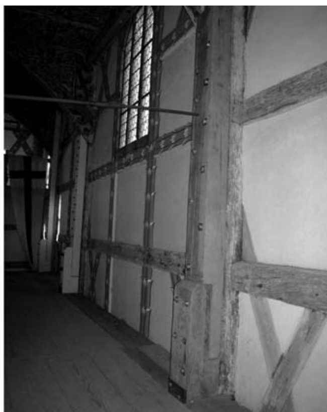
Figura 2. Aumento della sezione di un pilastro ligneo con guance lignee, Templum Pacis , Swidnica, Polonia. È evidente la rotazione della parete contrastata dal tirante (foto Tampone, 2009).
