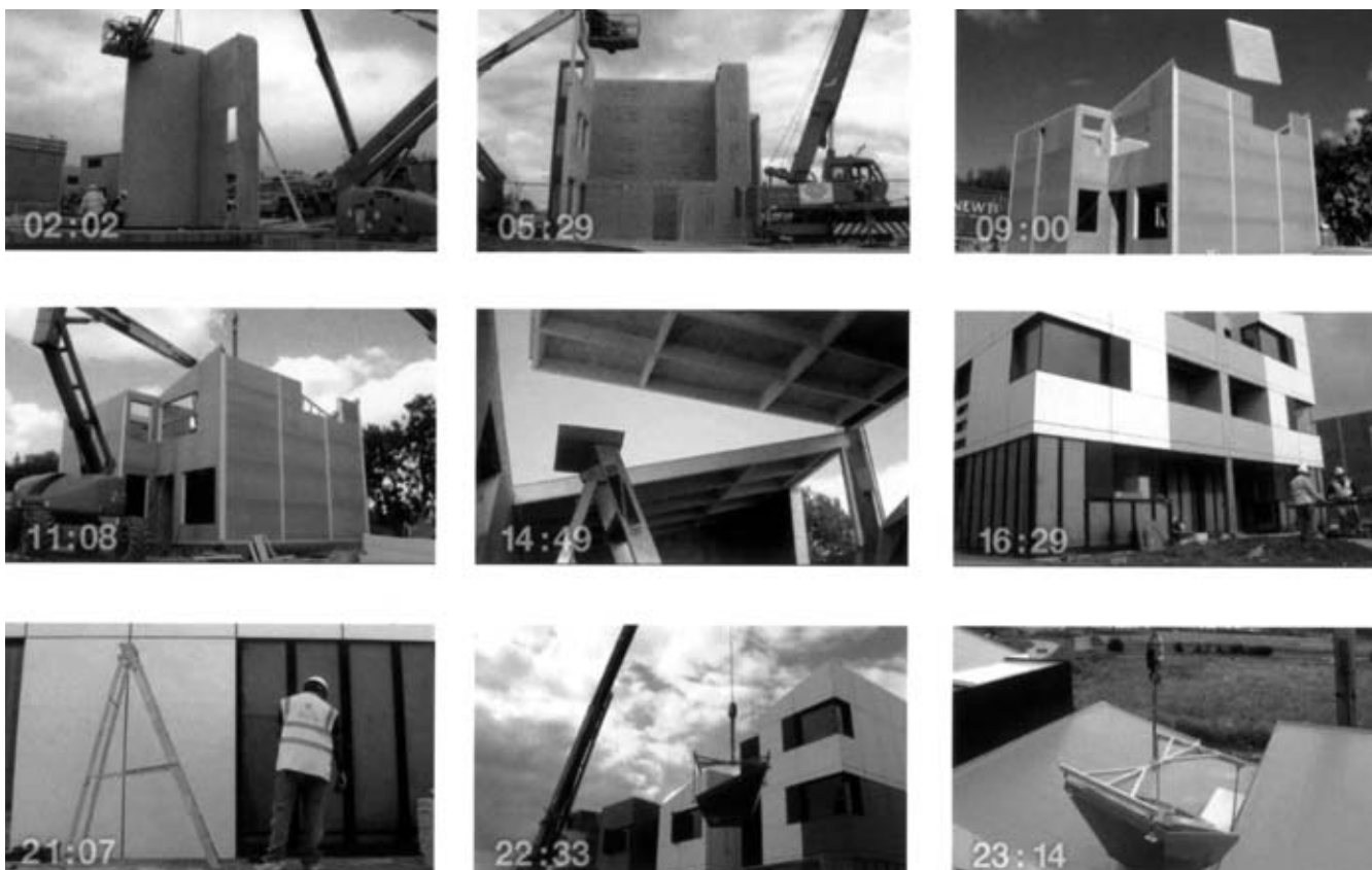
Figura 3b. Eco-residenze nel nuovo quartiere Oxley Woods a Milton Keynes (UK). Vista d'insieme di un'aggregazione dei moduli e fasi di montaggio del modulo abitativo (24h) (Fonte: Pappalettere Silvio).
